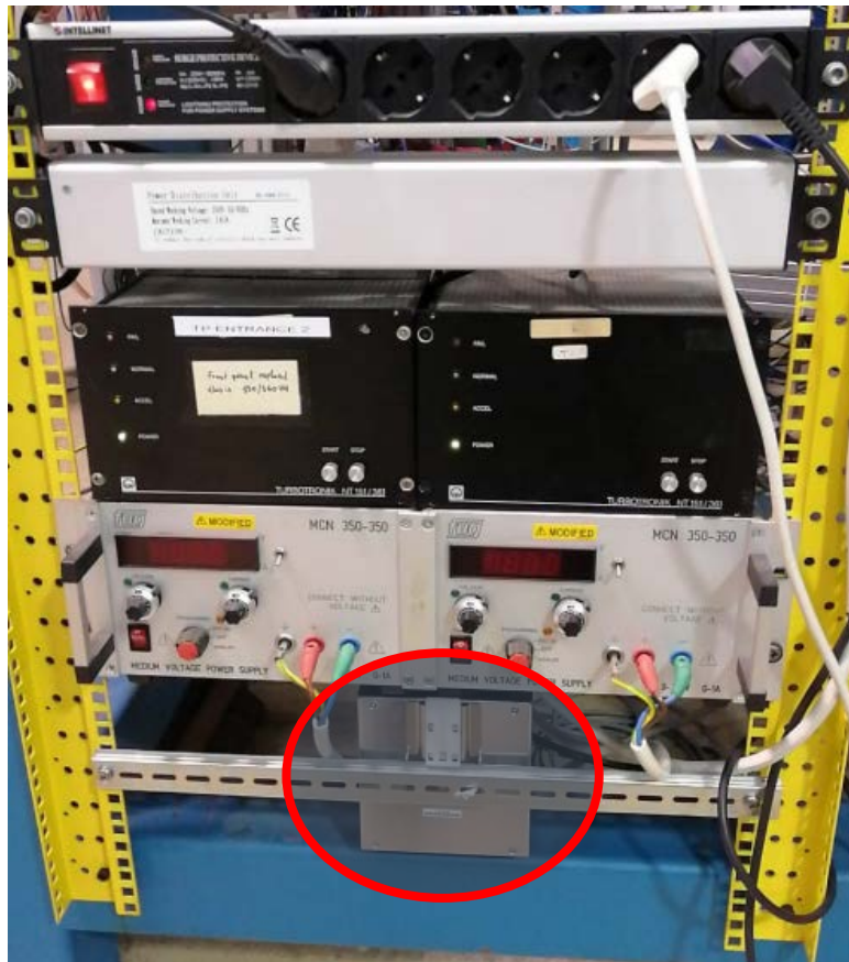
Figura 8 (Power supply GSI)
